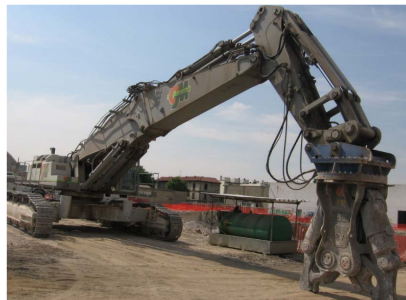
Peso operativo 190 ton, altezza perno braccio dem. 53m con pinza da 2500 kg
